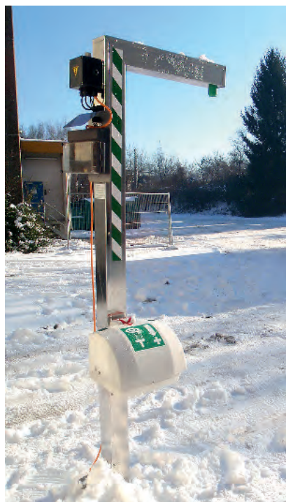
Notdusche im Winterbetrieb / Safety shower in wintertime
